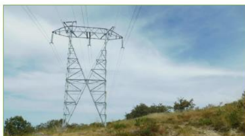
Detalle del apoyo de la LAT 132 kV As Conchas Frieira.
